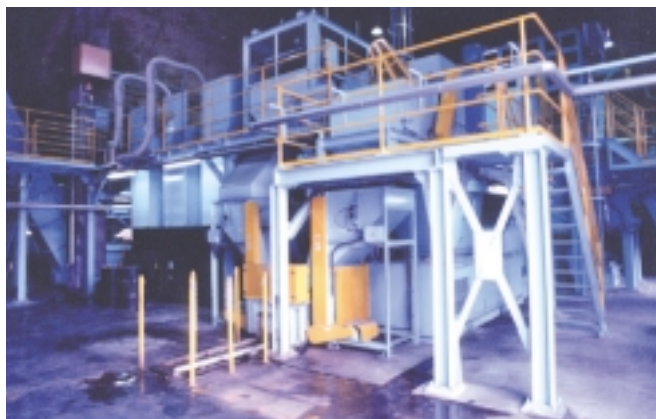
RDF製造設備（博多総合車両所）
